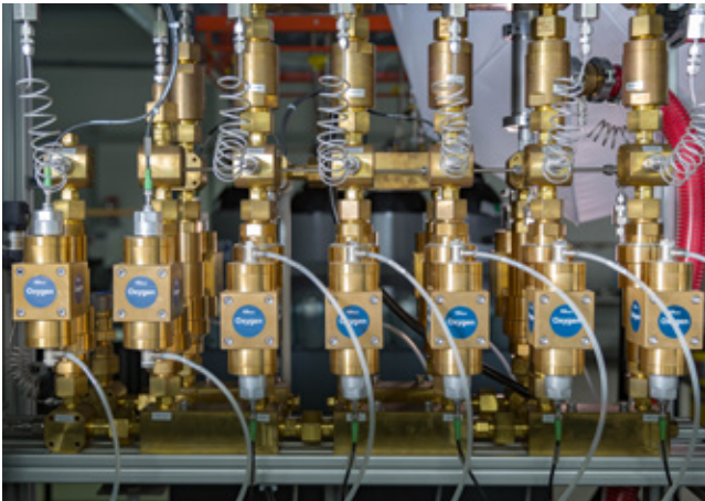
Beispiel einer gastechnischen Anlage mit TV17 Ventilbaugruppen:
